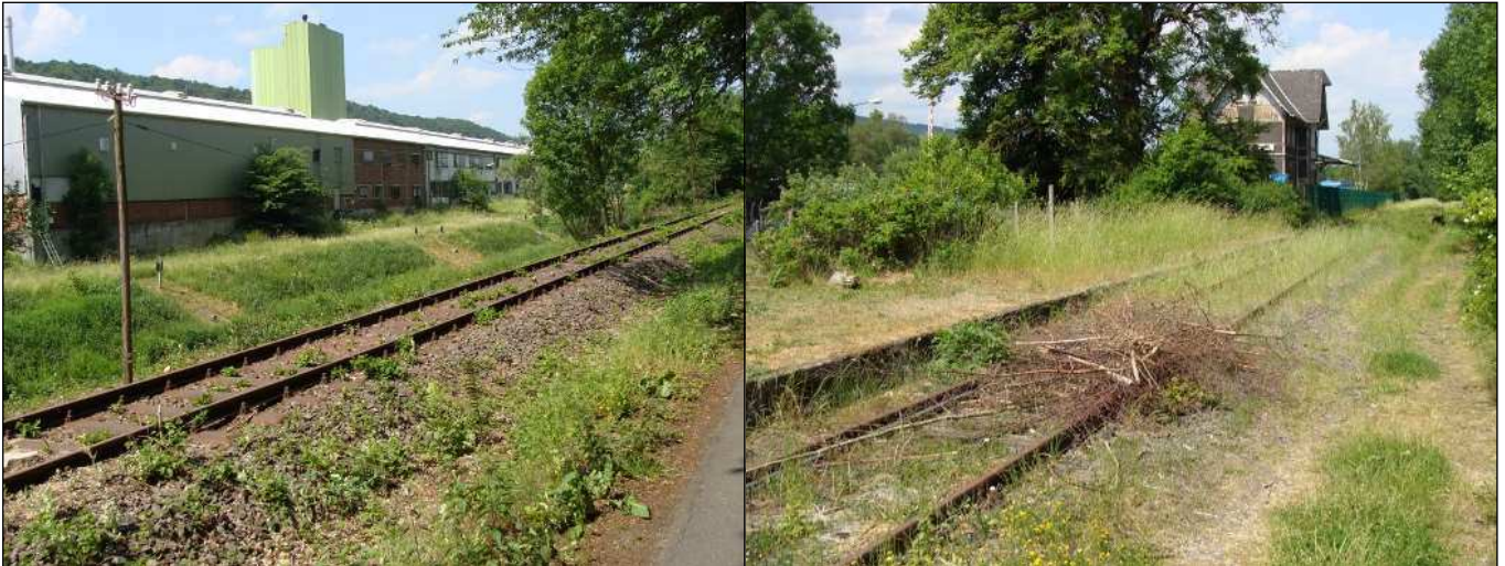
Freigeschnittene Trasse im Bereich Dillenburg (links), Bahnhof Frohnhausen (rechts). (Fotos: Thomas Kraft)
